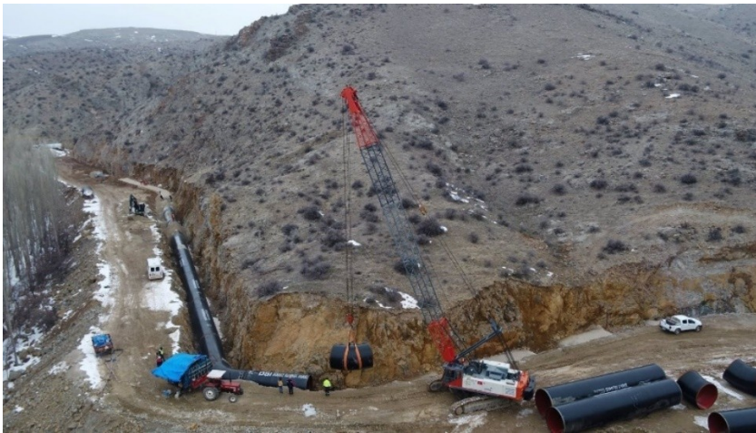
Obrázek 8. 13. Uzavřené potrubí pro přenos závlahové vody.
